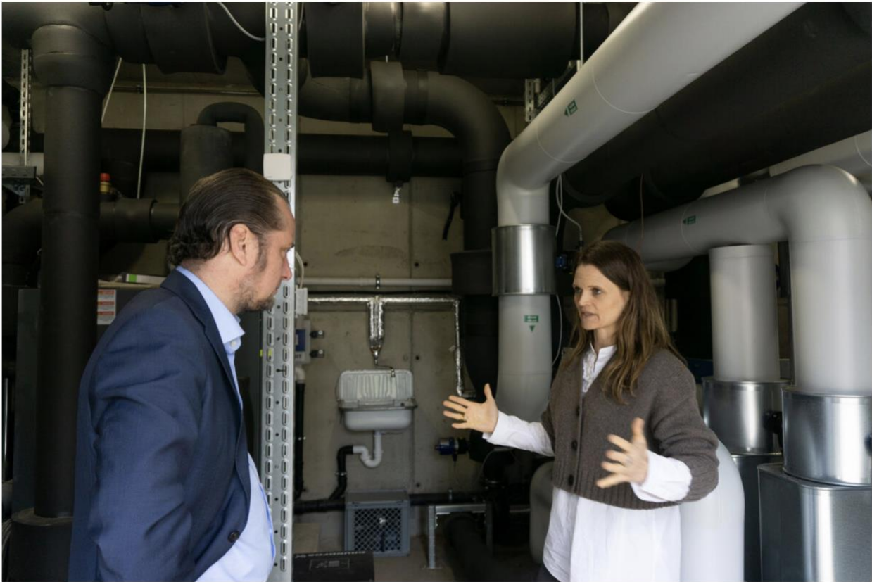
Johannes Kraft und Sarah Debor in der Heizzentrale, dem Herz des Quartiers (naturstrom AG)
