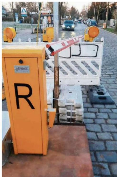
Die Schranke an der Hauptstraße, die eigentlich dafür gedacht war, dass Busse oder Müllfahrzeuge durch den Baustellenbereich fahren können, wurde offenbar von einem Laster einfach zerstört.
