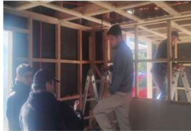
Taller de Electricidad
