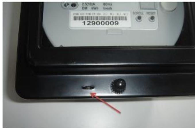
圖 2.2 電表外蓋鉛封孔
