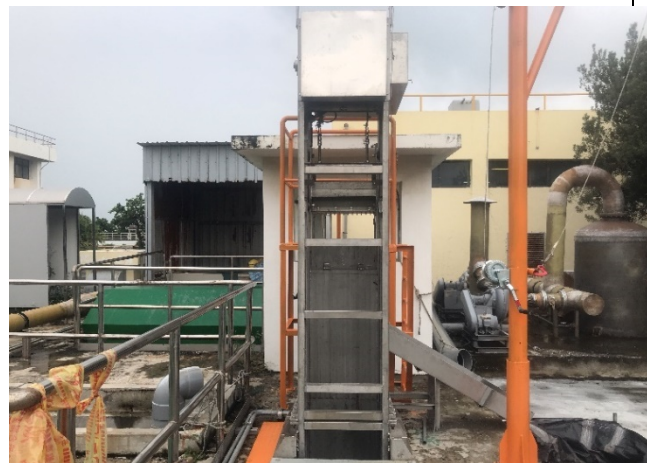
旗津抽水站增設固定式自動攔污機組
