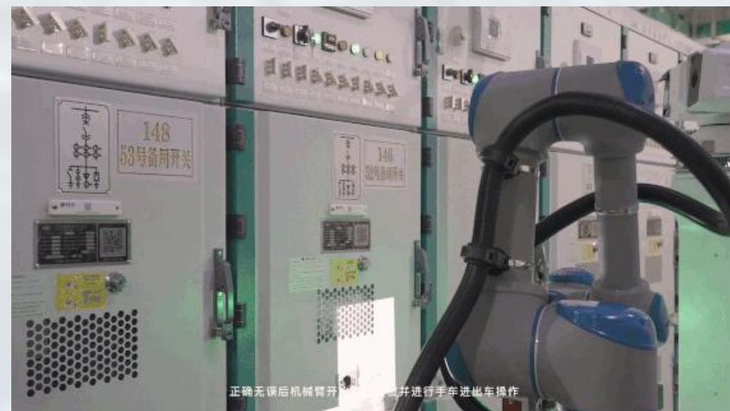
正确无误后机械臂开...并运行手车逆拖车操作
