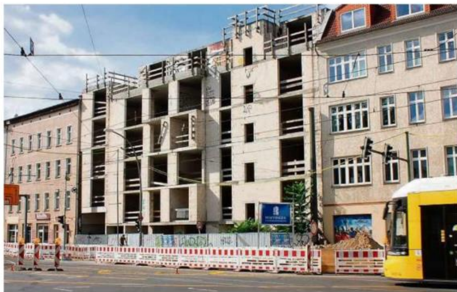
Seit vier Jahren eine Baustelle: Mit diesem Lückebau an der Berliner Allee geht es nicht voran. Foto: Bernd Wähler
