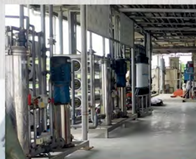
Sewage Treatment 污水處理
