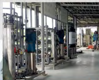
Sewage Treatment 污水處理
