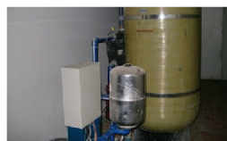
▲ 學生第一宿舍雨水回收設備
