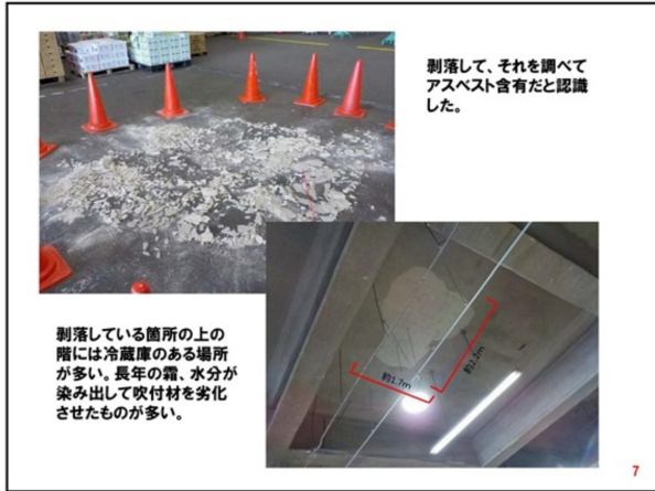
梁・桁のH鋼から剥落
