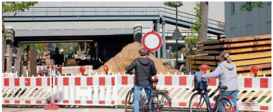
Seit fünf Jahren wird im Bereich der Eisenbahnbrücke über die Pankgrafenstraße am Bahnhof Karow gebaut. Derzeit werden Leitungen erneuert und tiefer gelegt. Voraussichtlich erst im Herbst 2024 wird die Unterführung wieder freigegeben. Foto: Bernd Wähler
