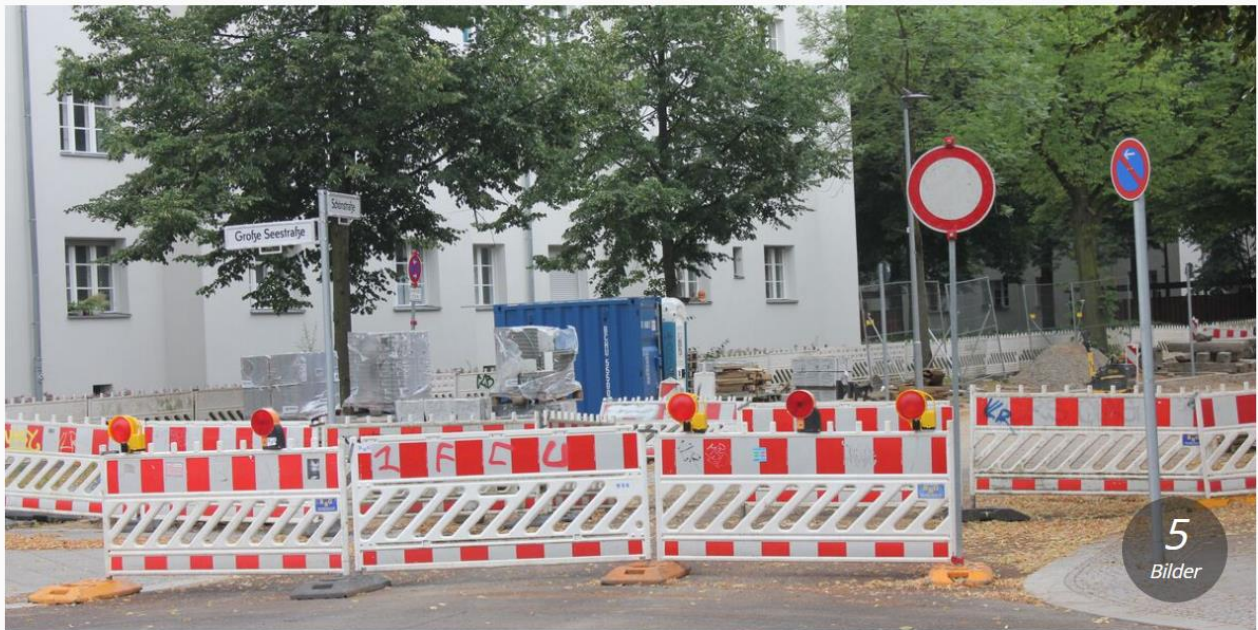
Zurzeit wird auf der Schönstraße im Abschnitt zwischen Große Seestraße und Blechenstraße gebaut. Der Straßenabschnitt ist komplett gesperrt. • Foto: Bernd Wähler • hochgeladen von Bernd Wähler
