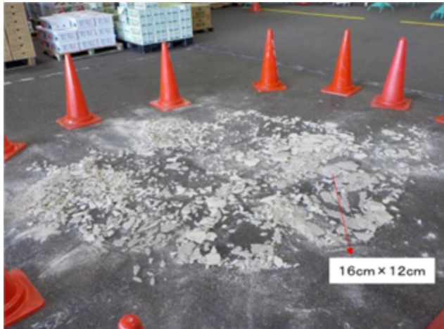
剥落した吹付材
