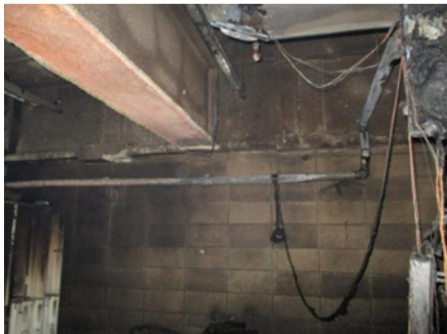
火災のあった現場
