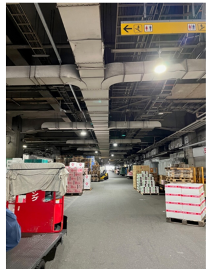
ダクトとパイプが所狭しと並んでいる天井
