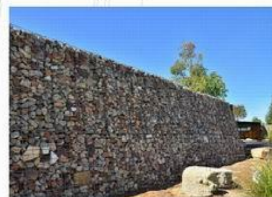
石籠護岸、石籠擋土牆設置，穩固潮溝、潮池及竹船停泊點之高程落差
